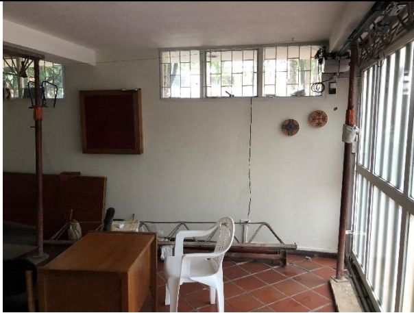
Fotografía 5. Fotografía al interior del garaje del inmueble ubicado en la Calle 118 No.70C-69 IN 2. Se observan la instalación de postes temporales de apuntalamiento para prevenir el asentamiento de la vivienda. Fecha fotografía. Marzo 12 de 2021
