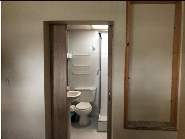
Fotografía 11. Fotografía al interior de una de las áreas ubicadas en el primer piso en la parte posterior del inmueble ubicado en la Calle 118 No.70C-69 IN 2. Fecha fotografía. Marzo 12 de 2021
