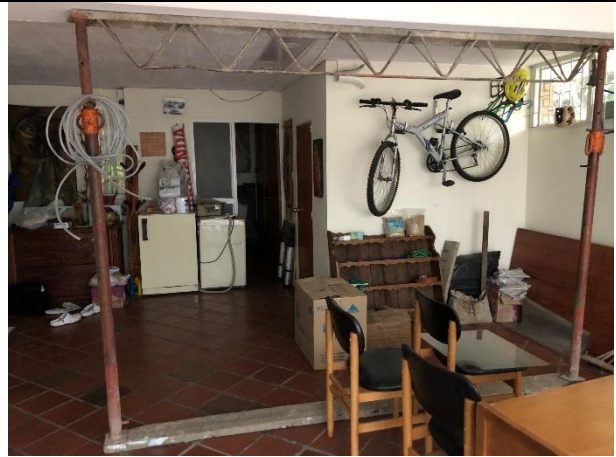
Fotografía 6. Fotografía al interior del garaje del inmueble ubicado en la Calle 118 No.70C-69 IN 2. Se observan la instalación de postes temporales de apuntalamiento para prevenir el asentamiento de la vivienda. Fecha fotografía. Marzo 12 de 2021
